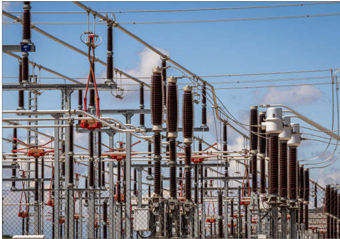
Detalle de una subestación eléctrica en Soria. MARIO TEJEDOR
